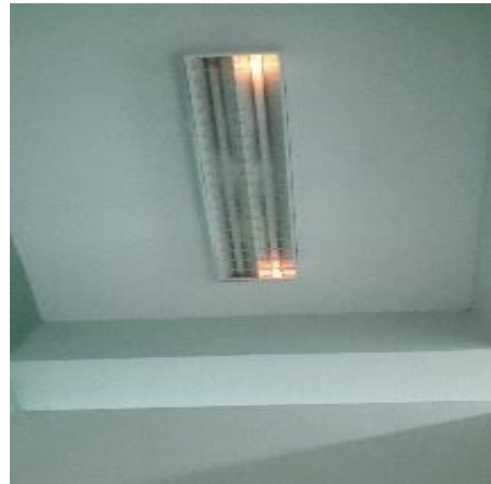
Luminaria de segundo piso del baño de mujeres sin funcional (quemados)
